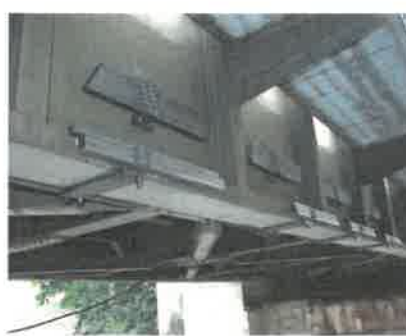
absorbeur sur platelage
