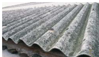
Toiture en amiante-ciment
