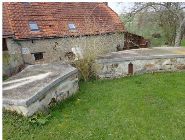
Figure 51 : Ancienne alimentation de la conduite aérienne
