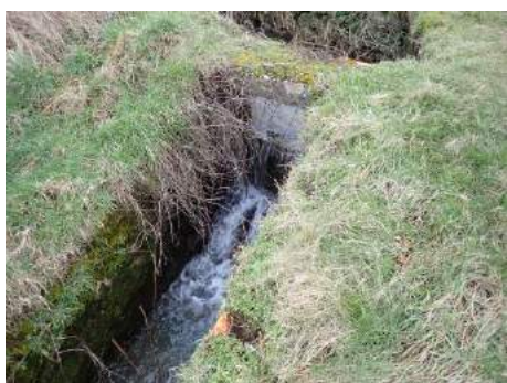
Seuil d'alimentation du bras de décharge
