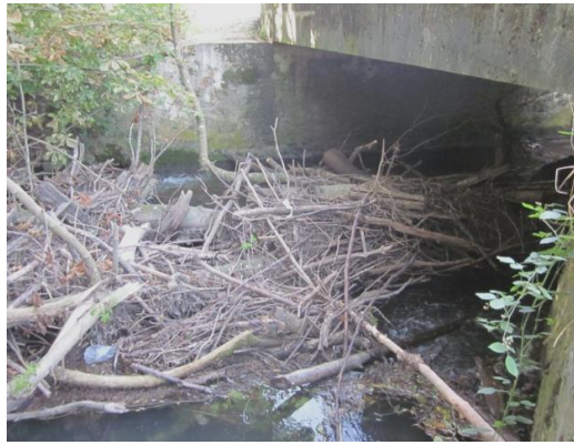
Figure 25: Embâcles sur le Petit Morin. Les embâcles sont des accumulations de débris végétaux entravant plus ou moins l'écoulement des eaux (Source : EDATER)
